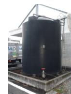
回収用タンク
